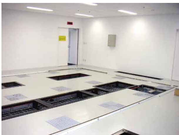
上下免震床外観
