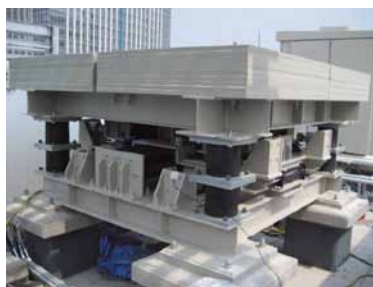
ビル屋上TMD
